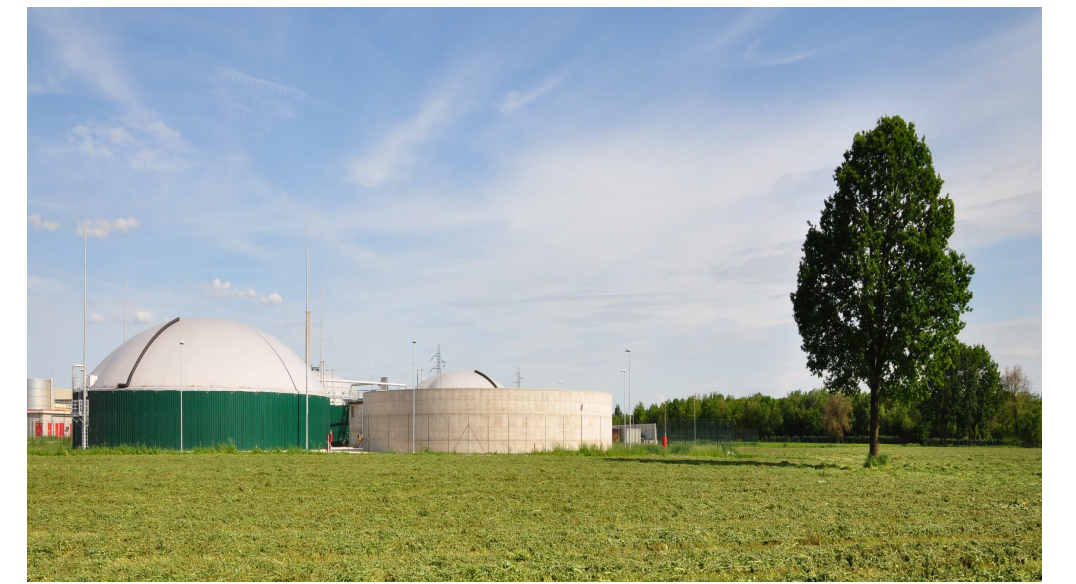
Biogas - 1 MW - Villa Poma (MN)
